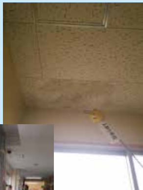
天井の雨漏り跡(現在修繕は終わっていません)→
